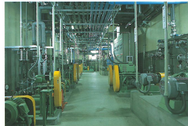
▲ ブロウポンプ室
